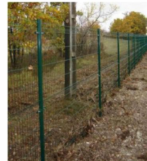
Figure 49: Exemple de clôture installée sur les parcs photovoltaïques
