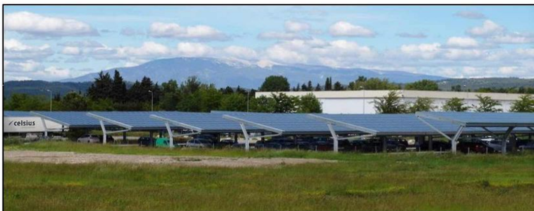
Figure 14 : Exemple d'ombrières photovoltaïques – Source : TotalEnergies Renouvelables France
