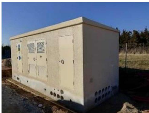
Figure 16 : Exemple de poste de livraison
