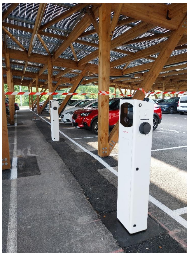
Mise en service de bornes de recharge électrique sous les ombrières photovoltaïques du siège de MACS
